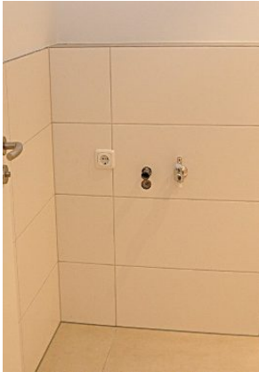
Waschmaschinenanschluss im Bad
